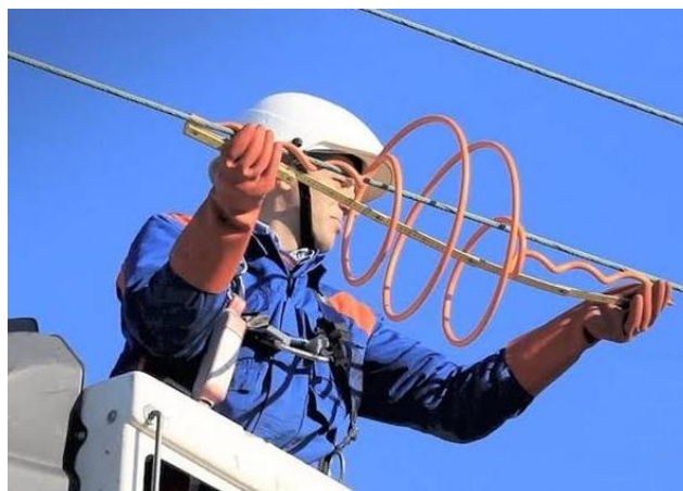
Figura 7.1/1: posizionamento delle spirali di dissuasione
