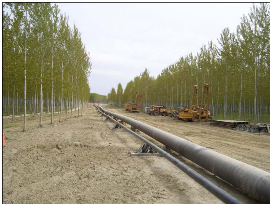
Fig. 1.6/D: Attrav. F. Po con met. 30" – Colonna della pipeline preassemblata sulla pista di varo
