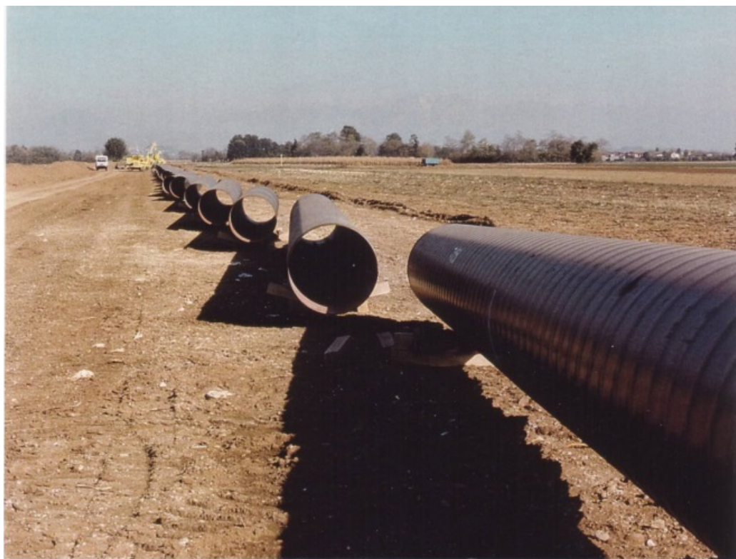
Foto 3.D: Esempio di sfilamento tubazioni
