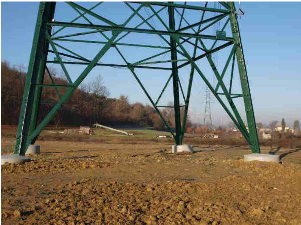
Figura 8-29: Va effettuata la sistemazione dei suoli interessati da realizzazione di nuovi tralicci/sostegni monostelo in zona di seminativo. Le dimensioni del traliccio rendono possibile l'accesso delle macchine agricole anche sotto il sostegno stesso.
