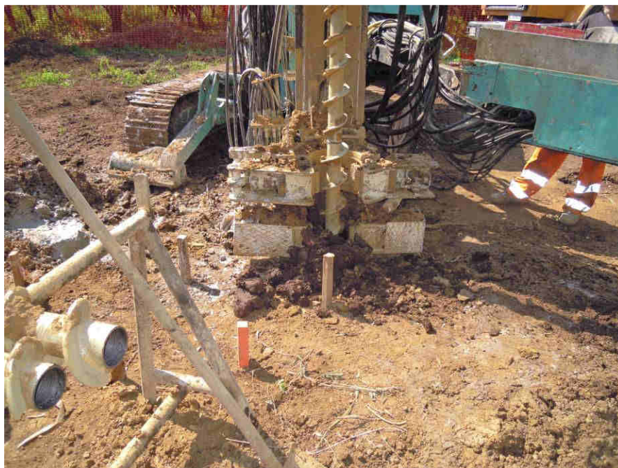
Macchina operatrice per la realizzazione di micropali tubfix; sistema di scavo mediante trivella elicoidale
