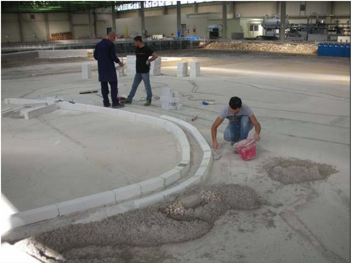
Fig. 2.24: Realizzazione della banchina di collegamento con lo scoglio Papuscia. Vista da terra.
