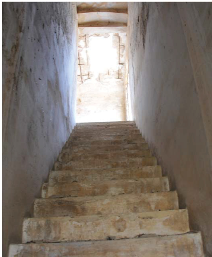
Figura 1-25. Masseria Frassino, viste degli interni al piano superiore e della scala di accesso interna.
