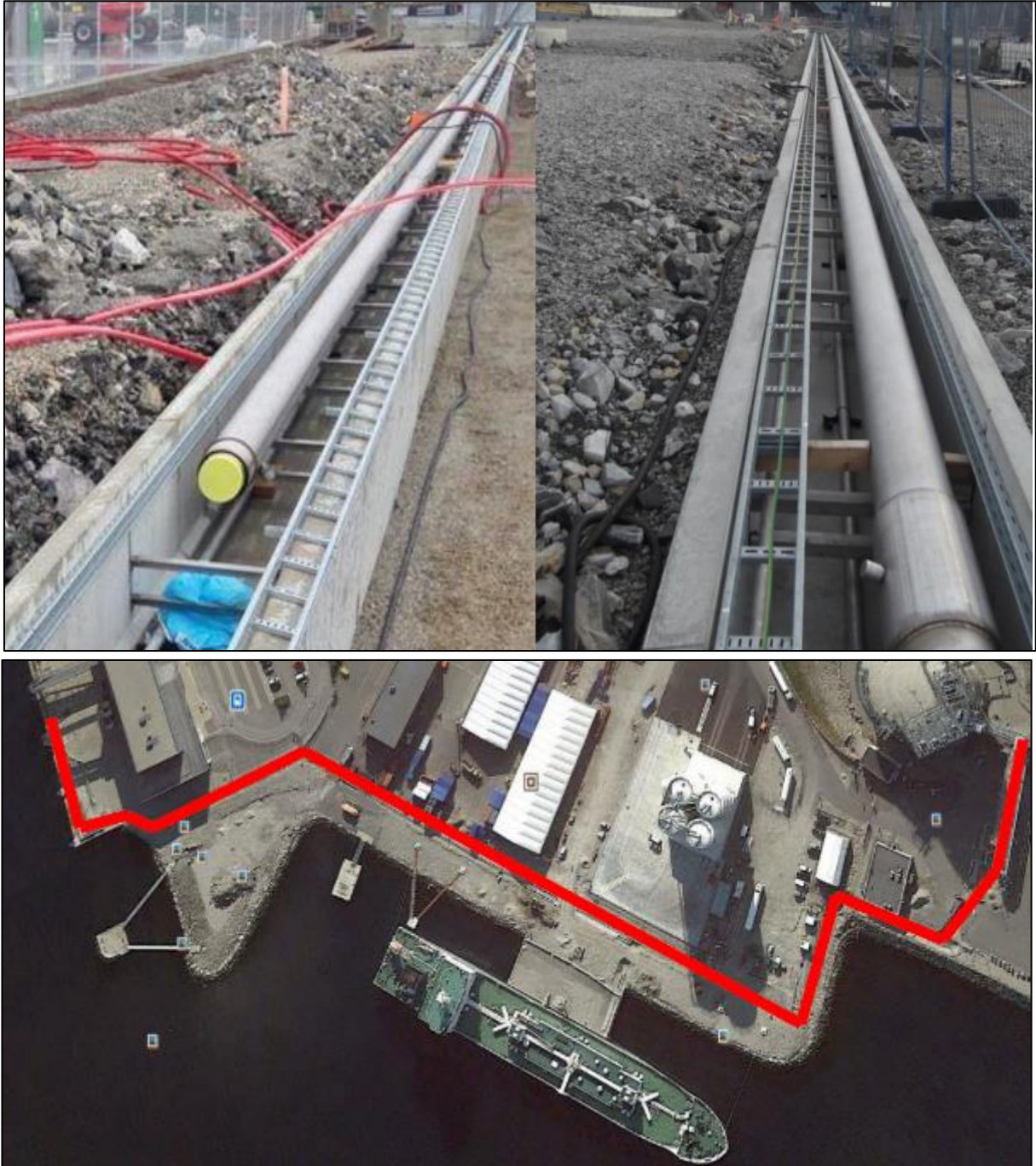
Figura 11: Impianto di Risavika (Norvegia) con cunicolo di passaggio tubazioni tipo VIP
