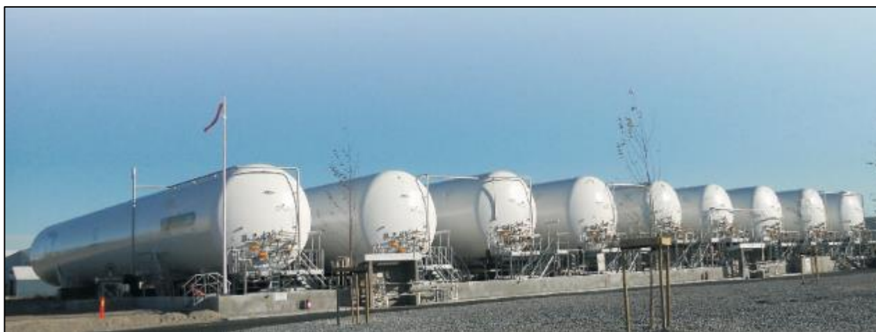
Figura 16: Esempio di serbatoi criogenici (impianto GNL a Fredrikstad – Norvegia)
