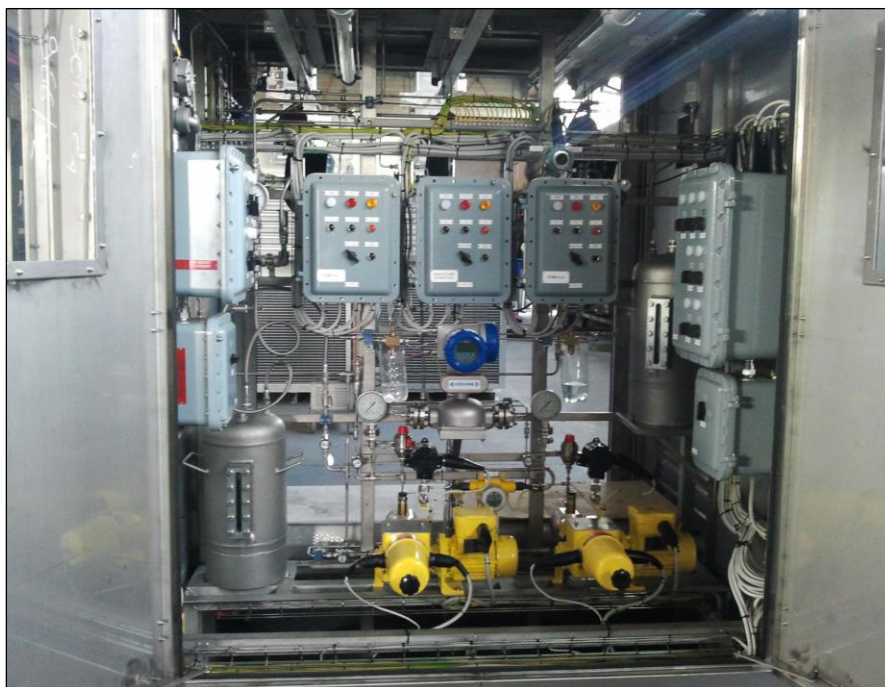
Figura 28: Sistema di Odorizzazione
