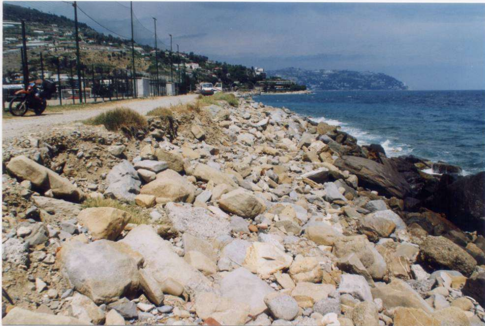
FOTO 1. Scarpata a mare in erosione del rilevato artificiale che ospita il campo sportivo (21.06.99)
