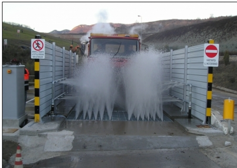
Figura 5 - Impianto lavaggio ruote
