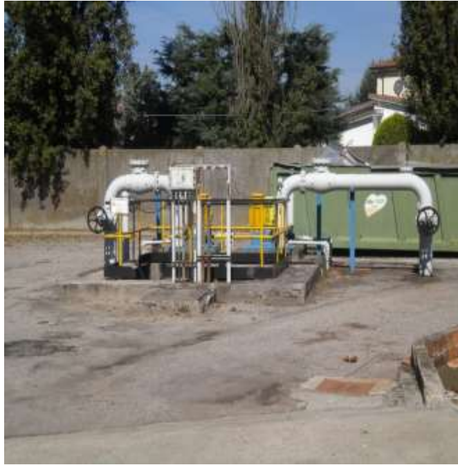
Figura 18: Vasca trappola acque oleose parco combustibili interno
