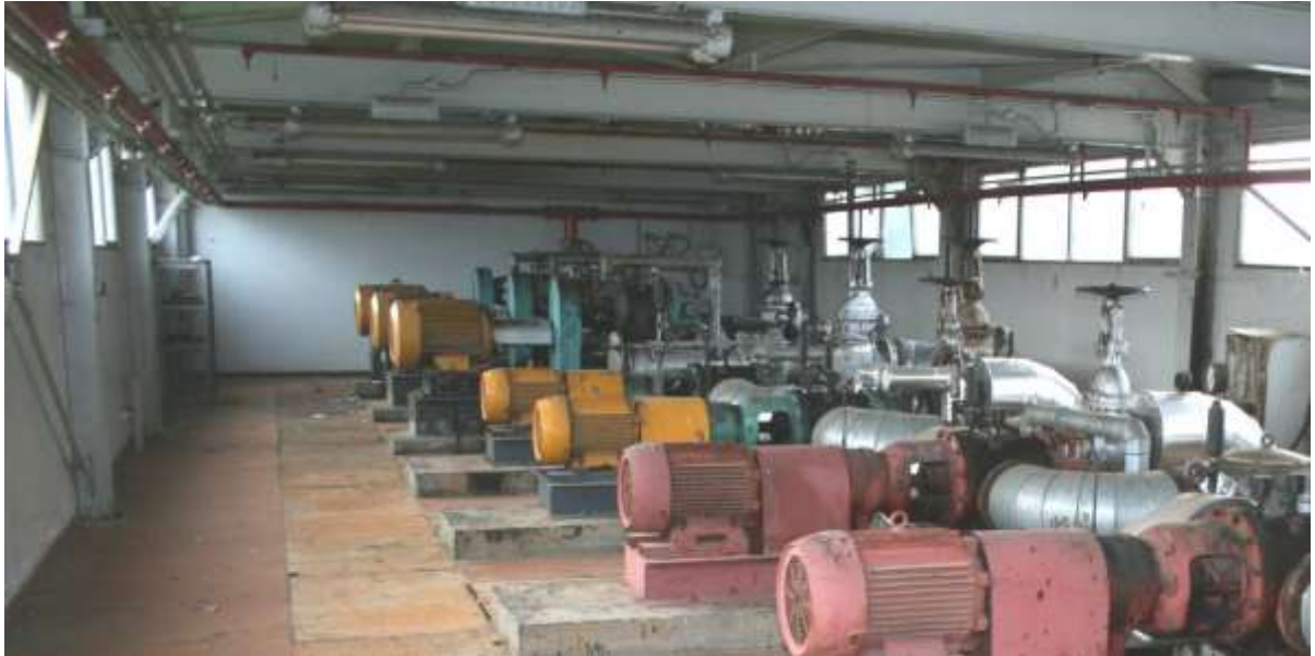
Figura 17: Interno edificio pompe
