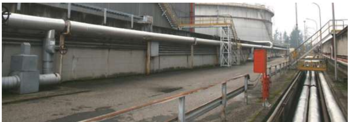
Figura 19: Tubazioni fuori terra ed interrato
