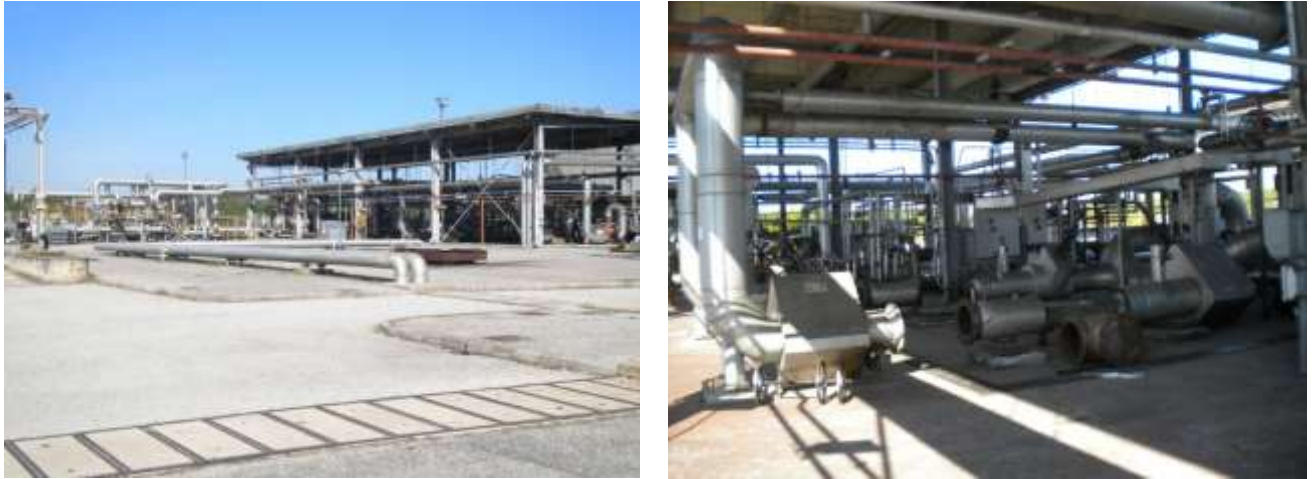
Figura 27: Tettoia pompe e riscaldatori area BSG
