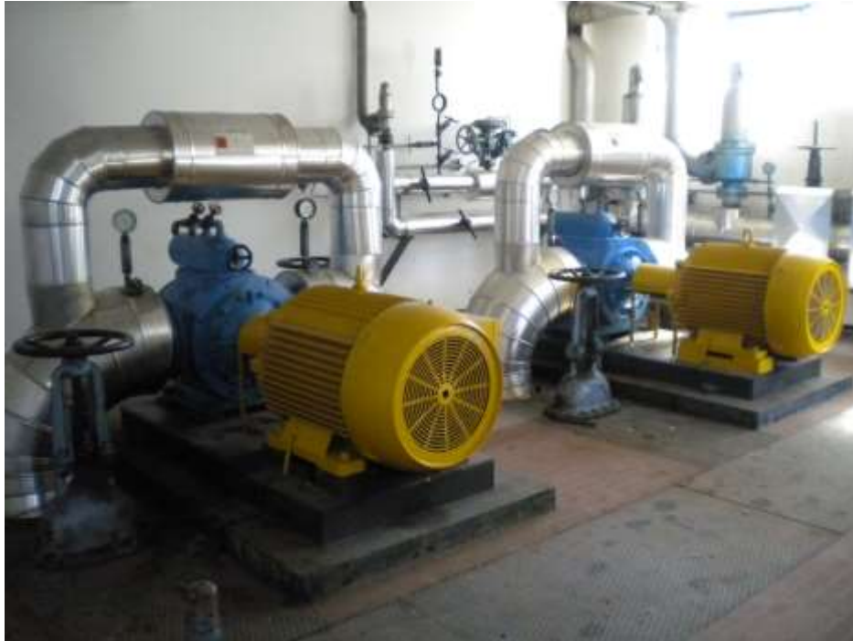
Figura 20: Pompe e tubazioni cabina travaso OCD in zona S1
