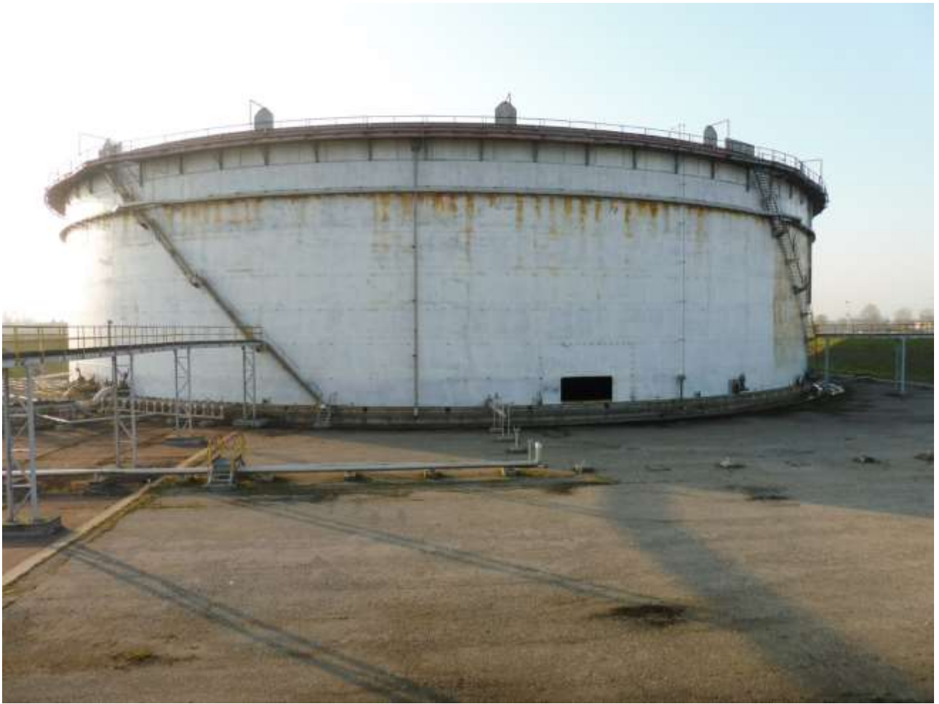
Figura 26: Serbatoio di BSG (sono visibili l'assenza del mantello di coibentazione e il varco di accesso praticato sulla parete)
