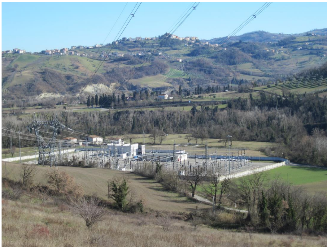
Foto 3 – Stazione elettrica di Teramo, impianto esistente; tratto di progetto dei raccordi 132kV alla SE Teramo sost. 16/4-16/5
