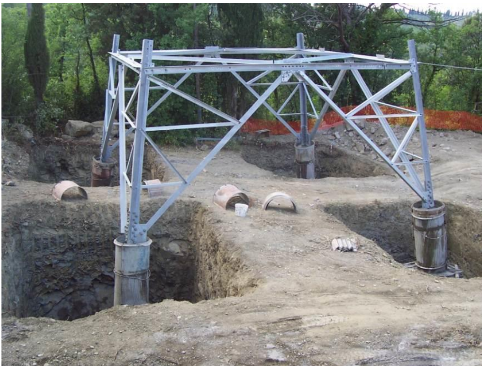
Figura 10 - Esempio di scavo per realizzazione di fondazione di un sostegno a traliccio
