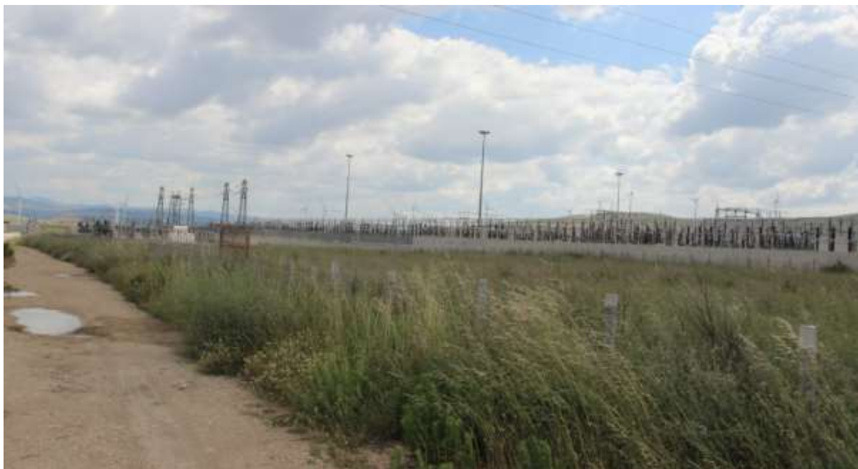
Figura 10 – Stazione RTN 380 kV “Deliceto” di proprietà Terna
