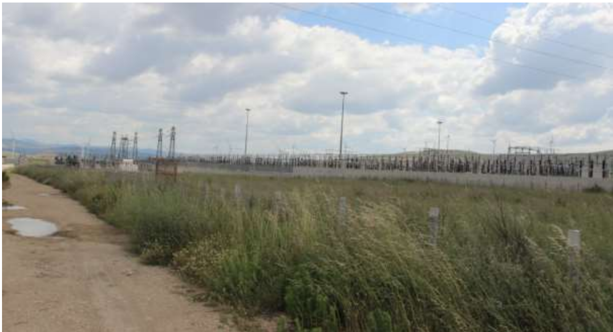
Figura 12 – Stazione RTN 380 kV "Deliceto" di proprietà Terna
