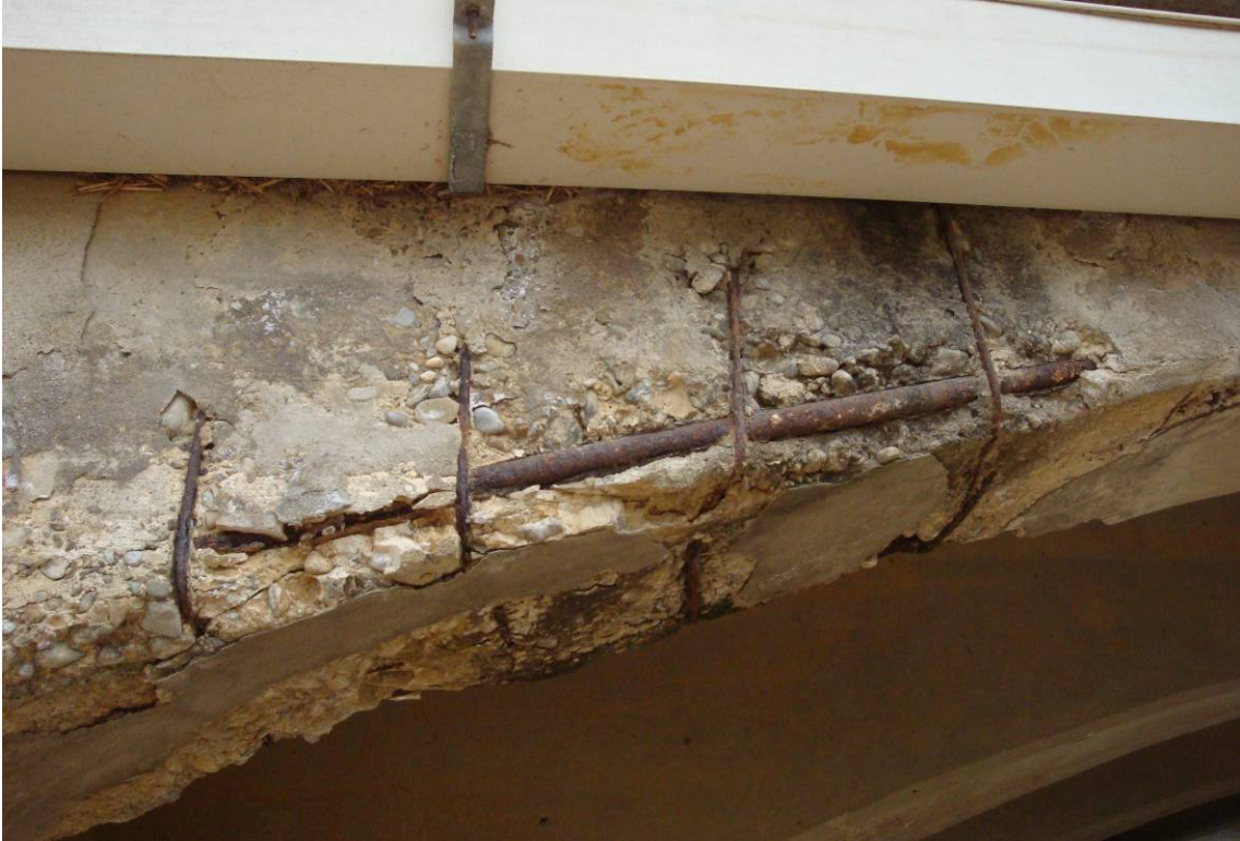
Foto 12 – particolare degrado travata valle
