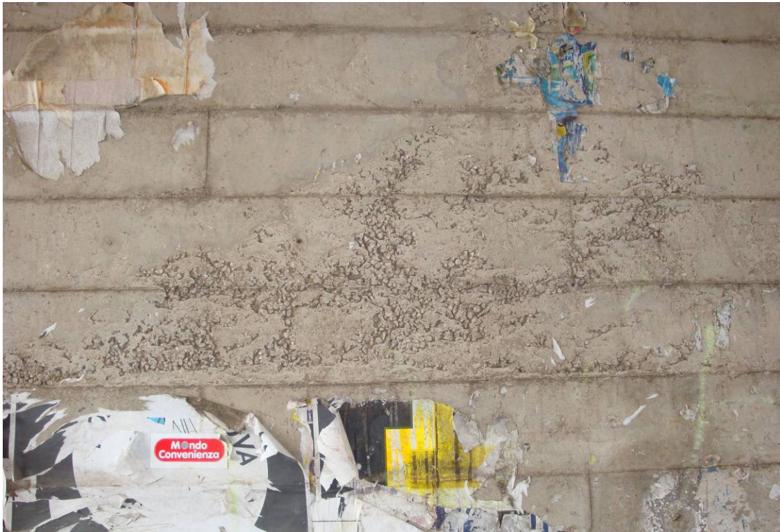
Foto 5 – Vespaio sul muro frontale della spalla
