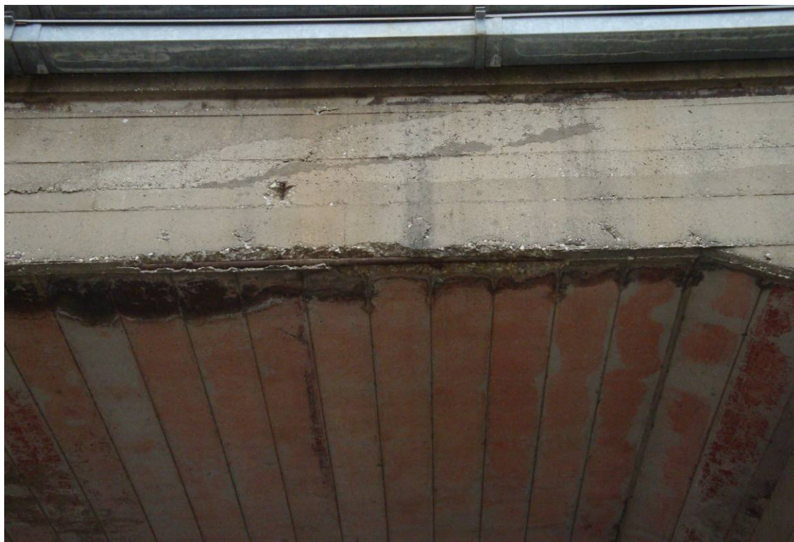
Foto 3 – Intradosso solettone: umidità e distacco copriferro
