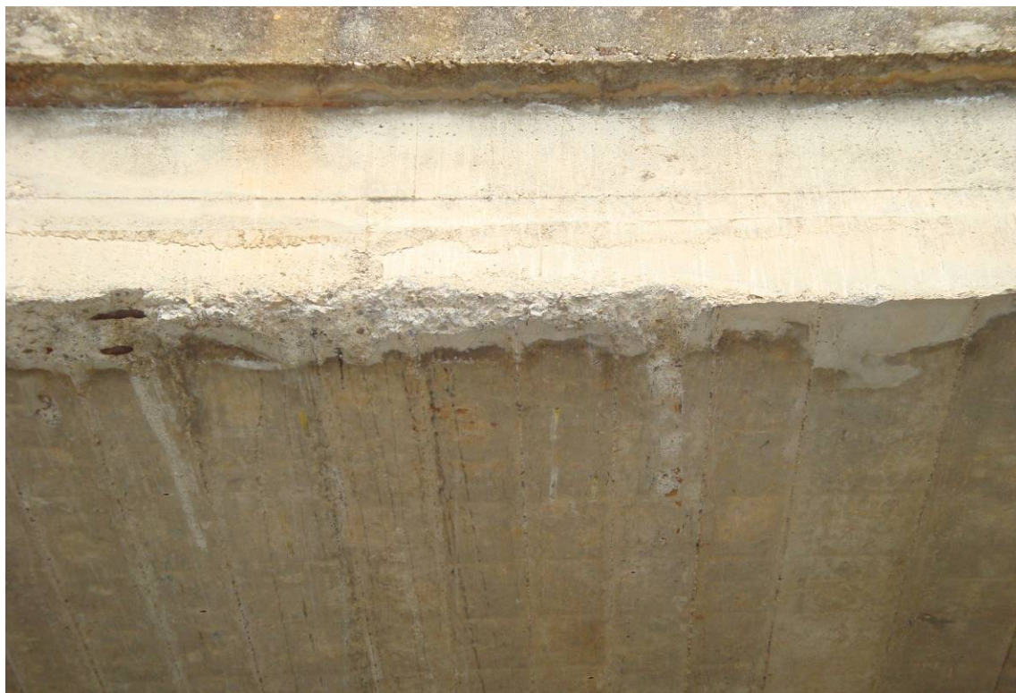
Foto 5 – Intradosso solettone – distacco copriferro
