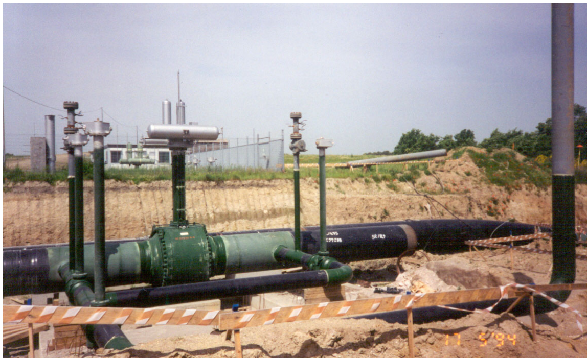
Foto 5.1/N: Impianto di intercettazione di linea (PIL)
