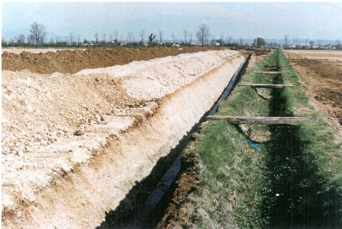
Foto 5.1/G: Tratto di condotta posata, si nota l'accantonamento dello strato humico separato dal materiale di scavo della trincea
