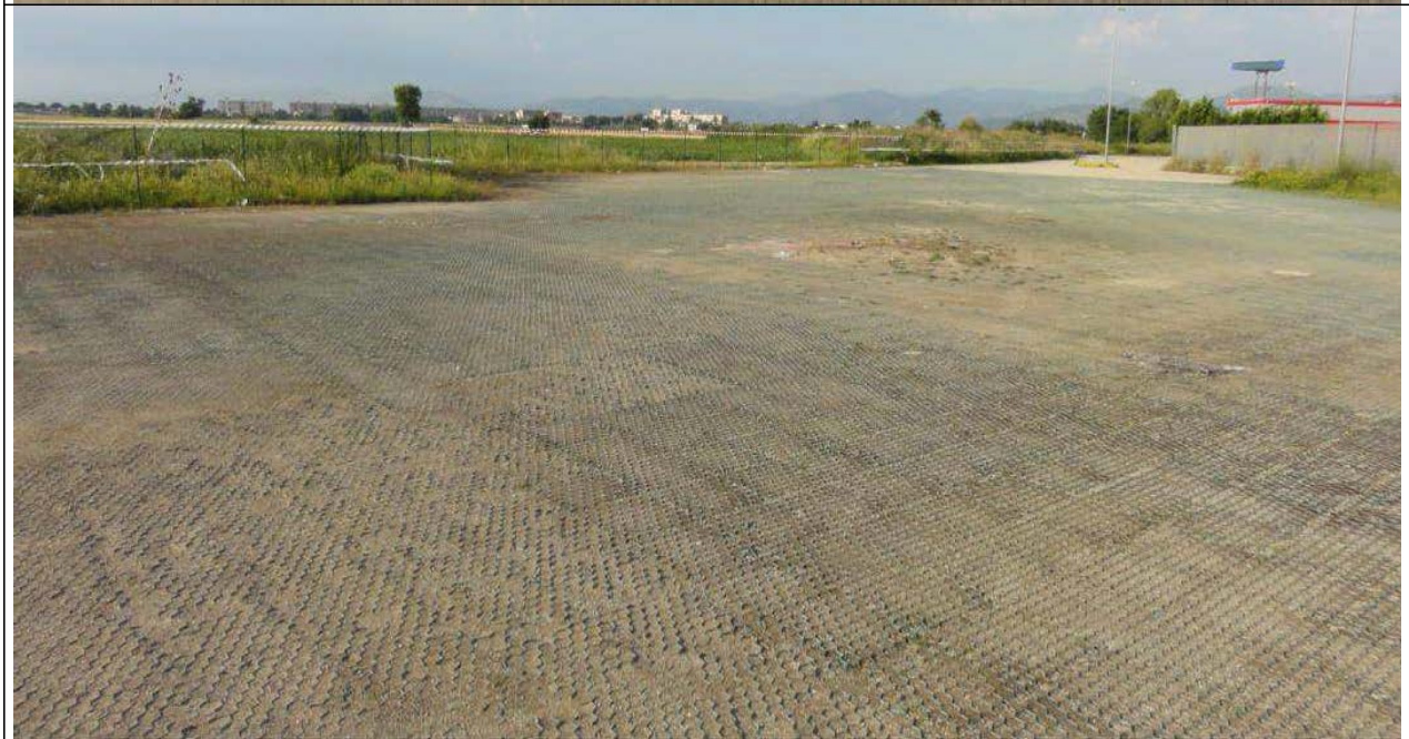
Viste della porzione di piazzale già pavimentato, nell'area destinata al cantiere di deposito terre.
