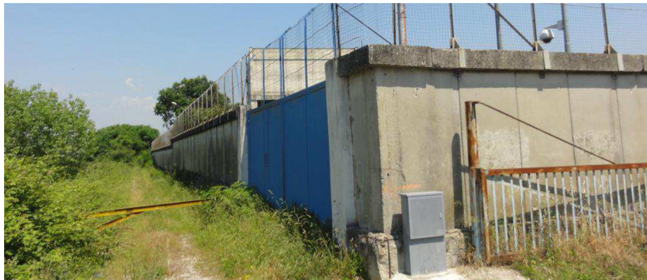
Vista del perimetro dell'area tecnica in ambito industriale in prossimità del ponte sui Regi Lagni.
