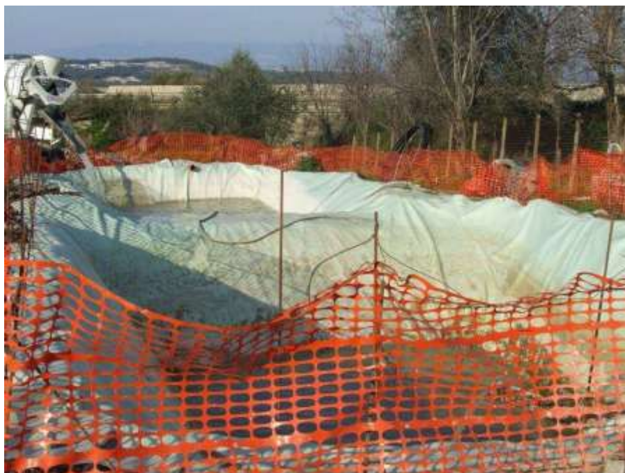
Figura 1 – Esempio di Vasca per il lavaggio delle canalette delle autobetoniere
