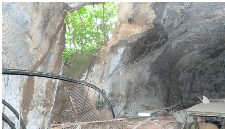
Foto 13 – il crollo della parete sinistra della cavità C2
