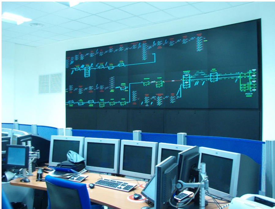
Figura 8 - Banco Operatore DCO del CTC Rete Sarda
