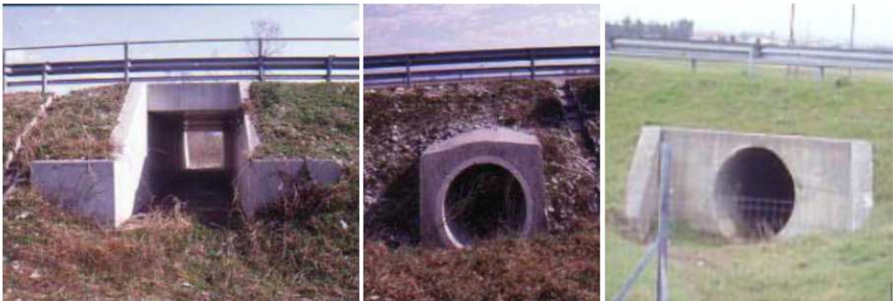
Figura 3-7 Attraversamenti faunistici. A destra: sottopasso scatolare per fauna minore. Al centro: passaggio faunistico a tubo. A destra: un tunnel di drenaggio delle acque; strutture di questo tipo possono assolvere la funzione di attraversamenti faunistici per le specie di adeguate dimensioni, purché effettivamente permeabili (es. non recintati) e mantenuti in efficienza. Fonte: Rapporto ISPRA 76.1/2011, Rapporto ISPRA 65.4/2010.
