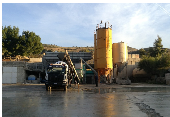
Figura 4-3 Impianto LOR. CAL. Di Porto Torres
