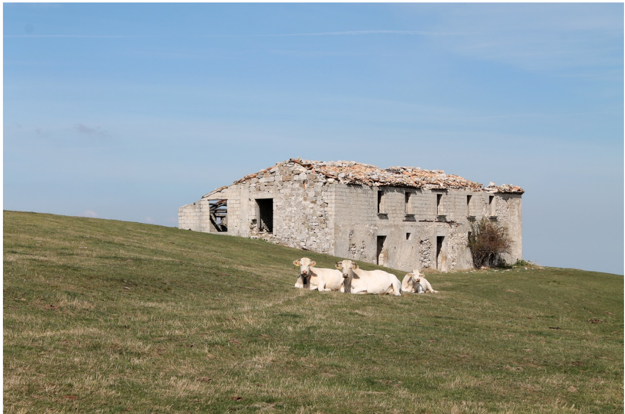
Figura 7 – Il Casone Martuscelli diruto e abbandonato, come la maggior parte dei fabbricati circostanti
