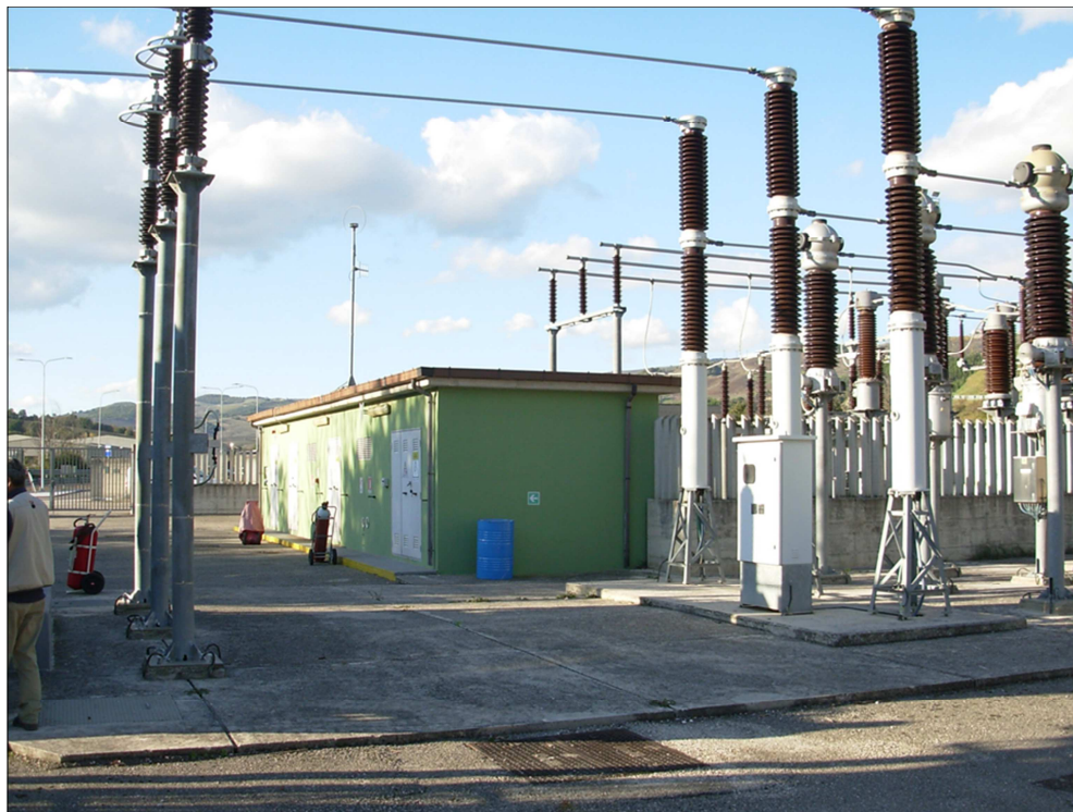
Figura 27: Vista dell'area interna della sottostazione elettrica di consegna (al centro l'edificio SSE esistente).
