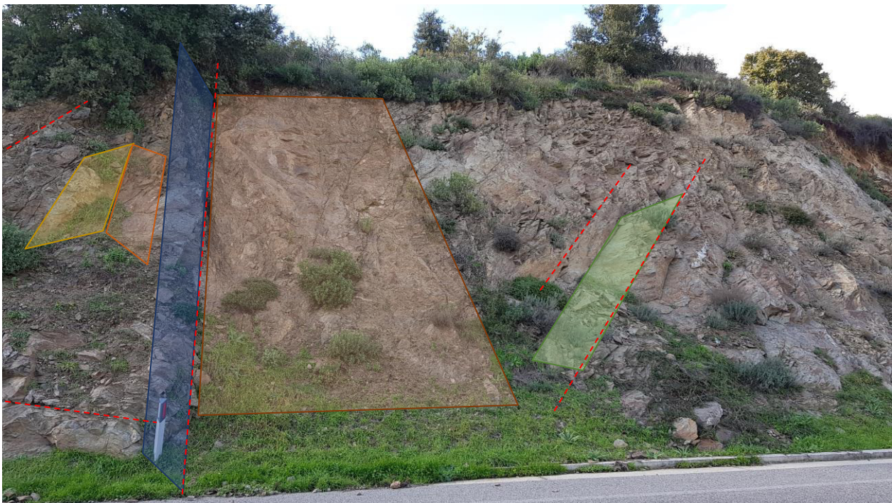
Figura 6.6 - tratto della S.S.389 soggetto a fenomeni gravitativi di scivolamento e/o crollo
