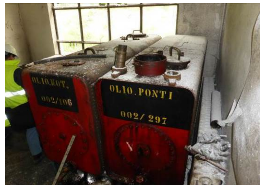
Rifiuti deposito olii
