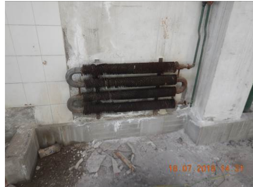
Radiatori vano officina
