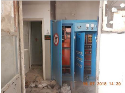
Quadri elettrici vano officina
