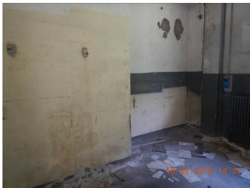
Rifiuti vari vano officina
