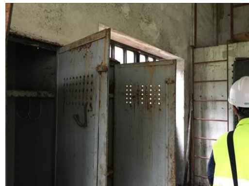
Rifiuti deposito olii
