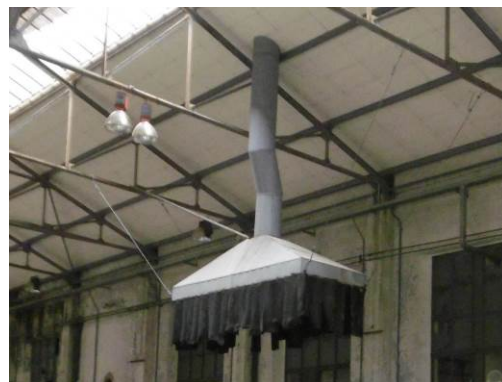
Cappe di aspirazione nella Rimessa
