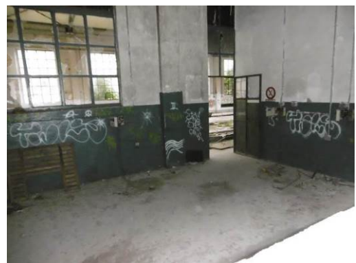
Rifiuti vano officina
