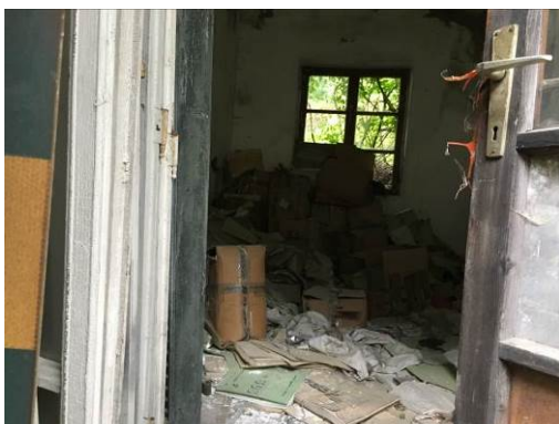
Edificio Gebäude „A6“ – Rifiuti interni
