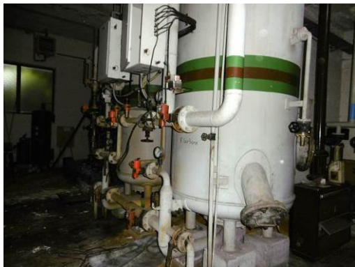
Silos carboni attivi
