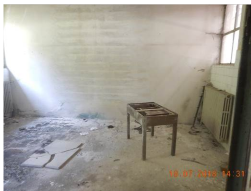
Rifiuti vari vano officina
