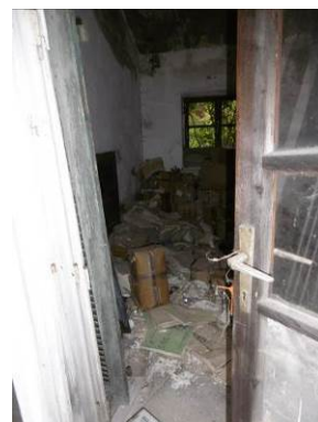
Edificio Gebäude „A6“ – Rifiuti interni
