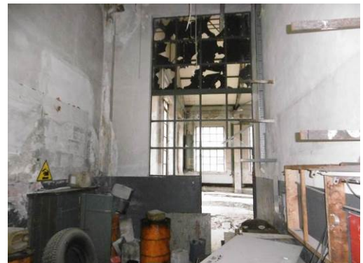
Rifiuti vano officina
