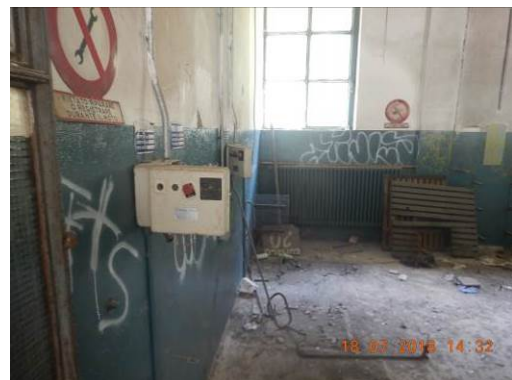
Apparecchiature elettriche erifiuti vari officina
