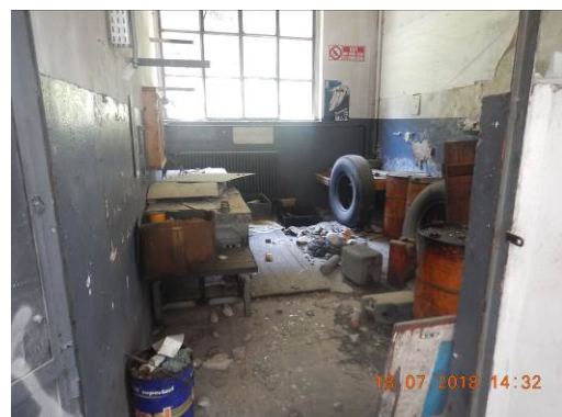
Rifiuti vari vano officina
