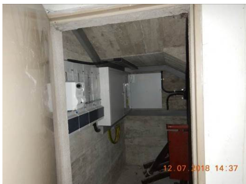
Locale contatori – Piano interrato
