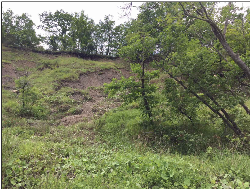
Dissesto che interferisce con la condotta in esercizio in corrispondenza del quarto ambito di intervento
