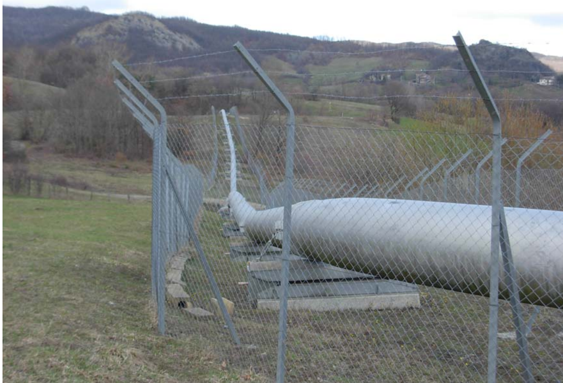
Foto 2.15/A: Tratto scoperto della tubazione DN 750 (30") in dismissione
