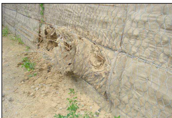
Figura 7. Svuotamento del riempimento vegetale dovuto ad un urto sul paramento
