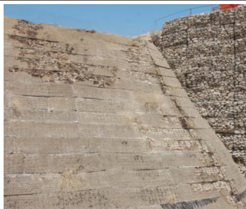
Mancanza di crescita di vegetazione sul paramento
