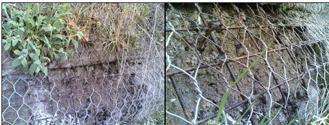
Figura 8. Perdita di materiale fine a causa di incendio e conseguente danneggiamento del ritentore di fine. Il terreno vegetale dietro al paramento rimane esposto.
