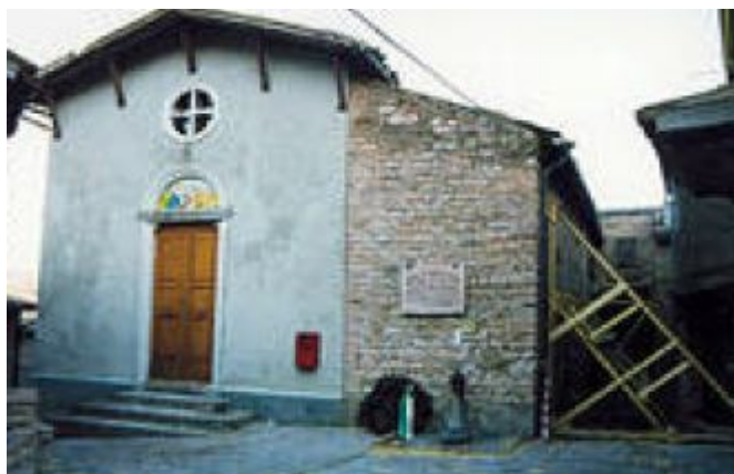
Figura 6.1 – Esempio di sistema di puntelli inclinati esterni
