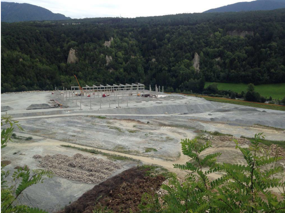
Foto del deposito di Hinterrigger – situazione attuale.
