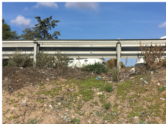
Foto 8: Criticità riscontrate agli arginelli
