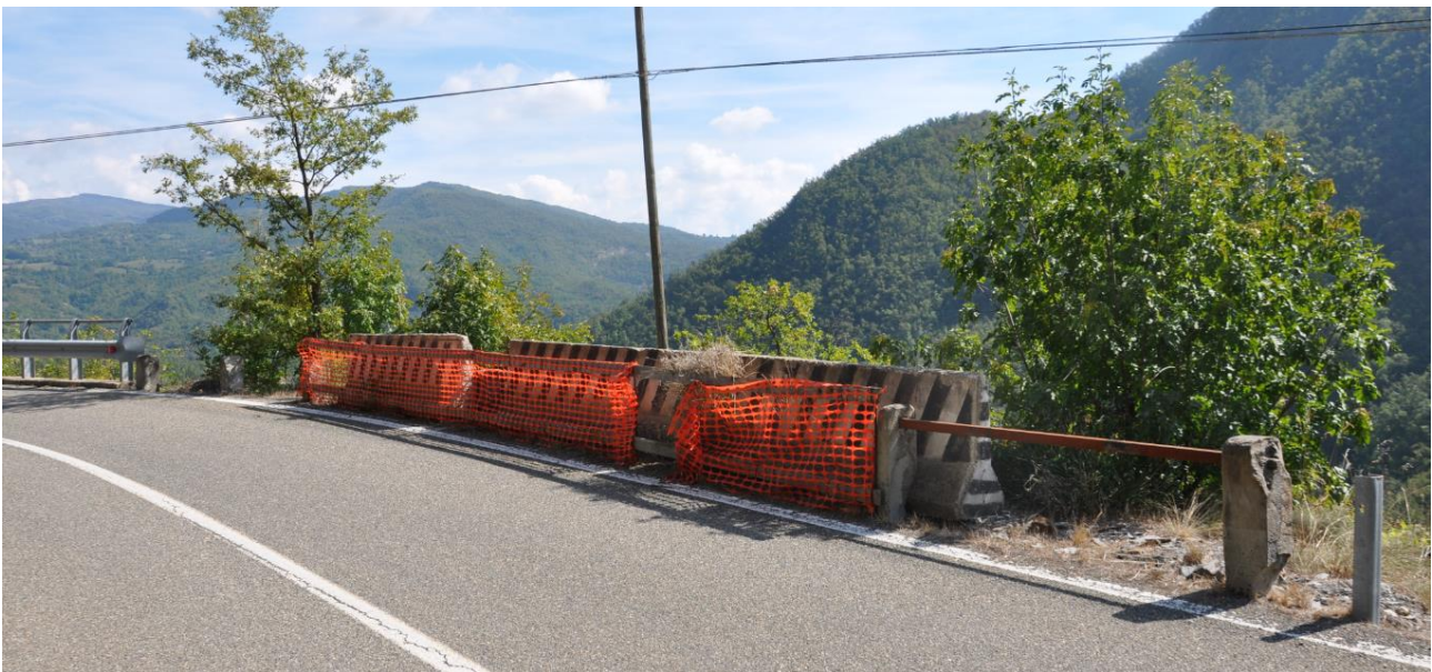
Quadro fotografico – Elementi di degrado presenti sulla attuale S.S. 45 della Val Trebbia.
