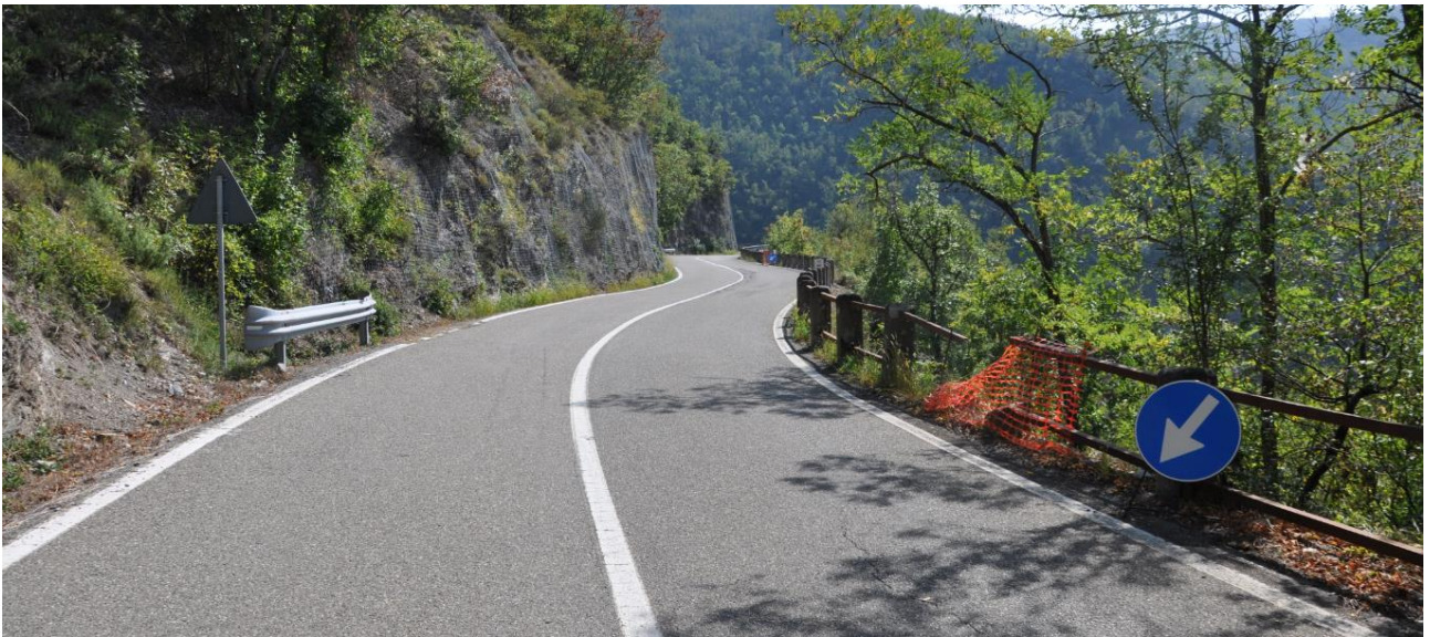
Quadro fotografico – Elementi di degrado presenti sulla attuale S.S. 45 della Val Trebbia.
