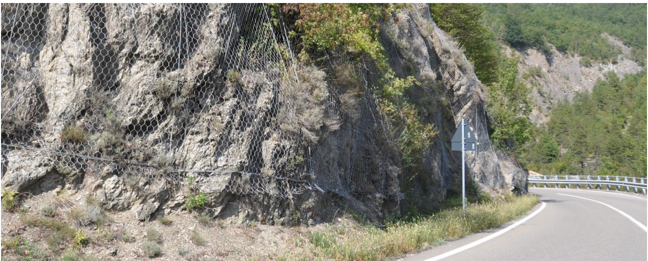
Quadro fotografico – Elementi di degrado presenti sulla attuale S.S. 45 della Val Trebbia.
