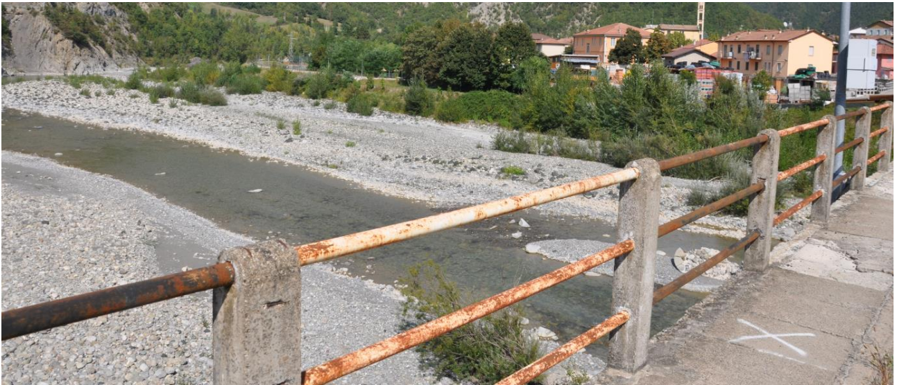
Quadro fotografico – Degrado presente sulla attuale S.S. 45 della Val Trebbia (Ponte Marsaglia).
