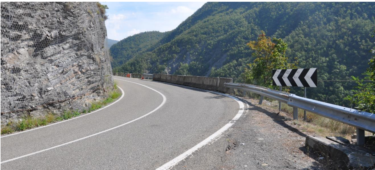
Quadro fotografico – Elementi di degrado presenti sulla attuale S.S. 45 della Val Trebbia.
