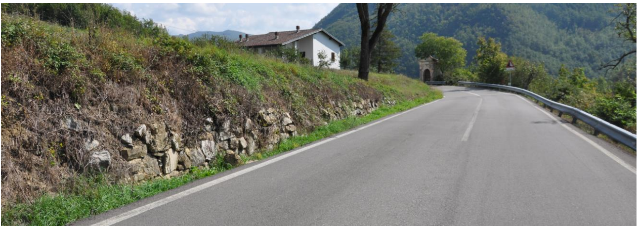
Quadro fotografico – Elementi di degrado presenti sulla attuale S.S. 45 della Val Trebbia.
