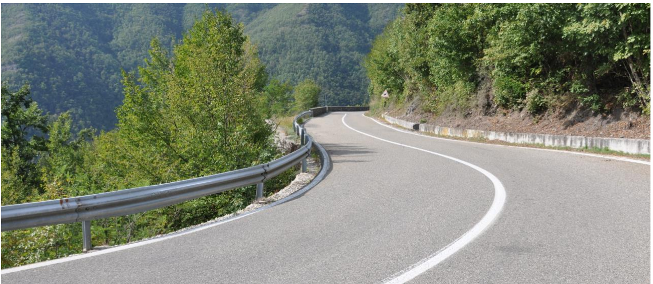
Quadro fotografico – Elementi di degrado presenti sulla attuale S.S. 45 della Val Trebbia.
