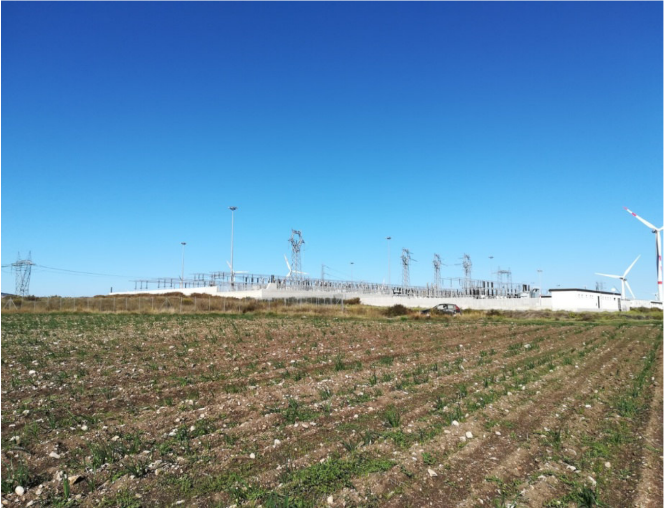
Figura 10_Sottostazione elettrica esistente
