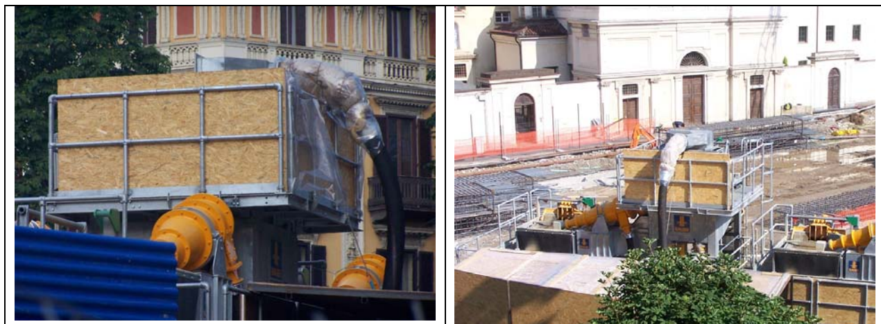
Figura 6.6 Insonorizzazione impianto dissabbiatore
