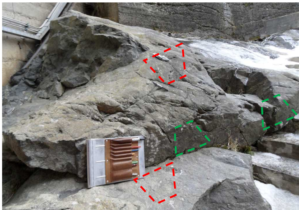
Fig. 4.7 – Particolare del sistema K1 (linea verde) e del sistema K2 (linea rossa) a valle della spalla destra (Stazione strutturale 2 e 3).
