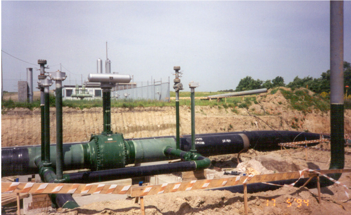
Foto 5.1/N Impianto di intercettazione di linea (PIL)
