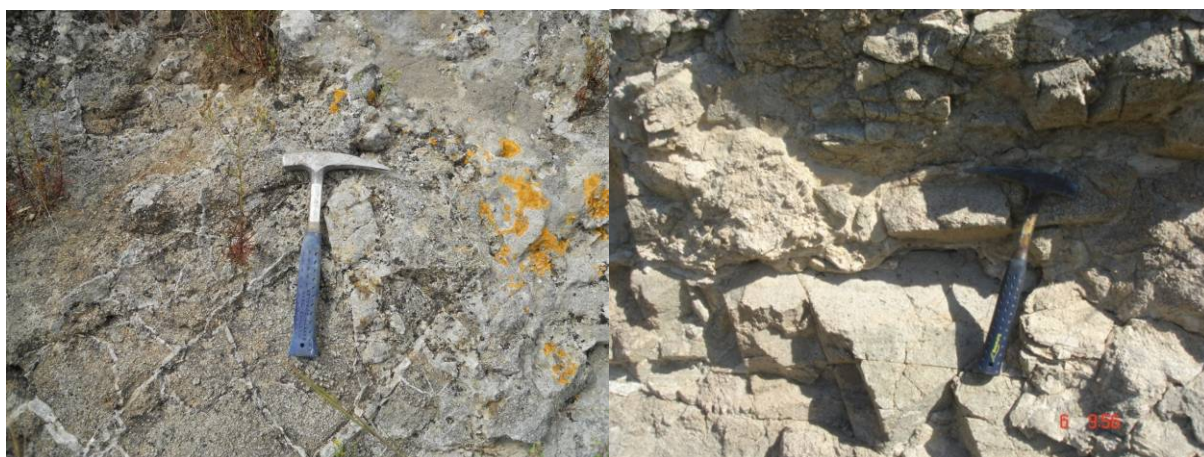
Fig. 3.6 - Affioramento del substrato granitico intensamente fratturato affiorante nel settore meridionale (sinistra) e nord-orientale (destra) dell'area esaminata.
