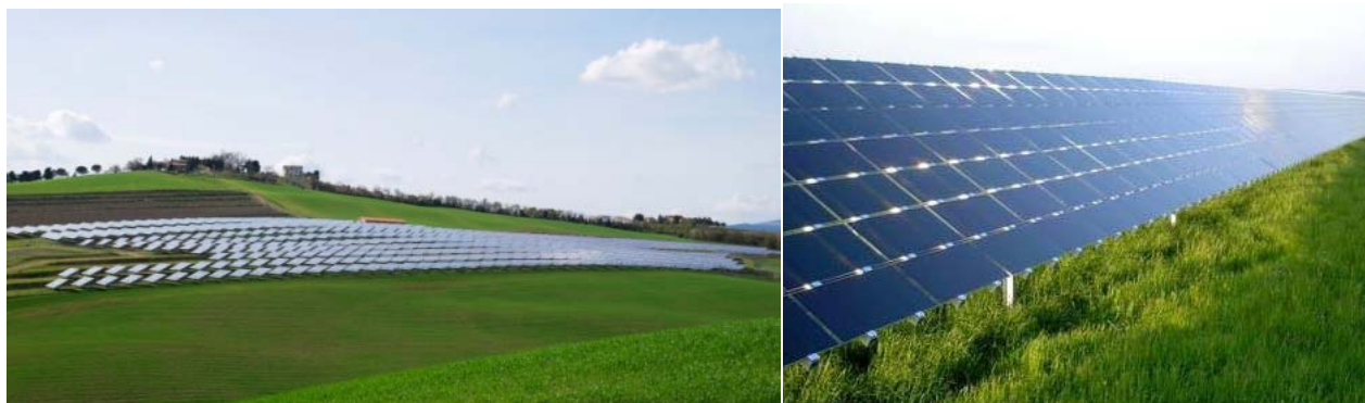
Fig. 4 Esempi di campo fotovoltaico
