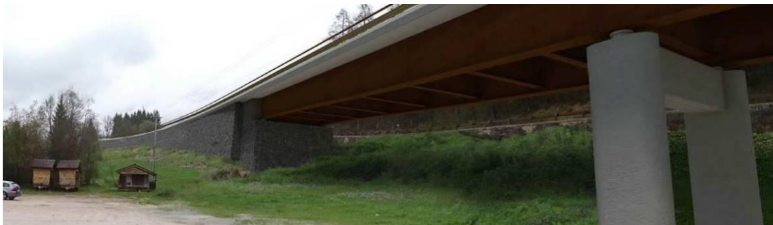
Figura 4.4 - La zona sottostante il viadotto in corrispondenza del parcheggio della zona artigianale.
