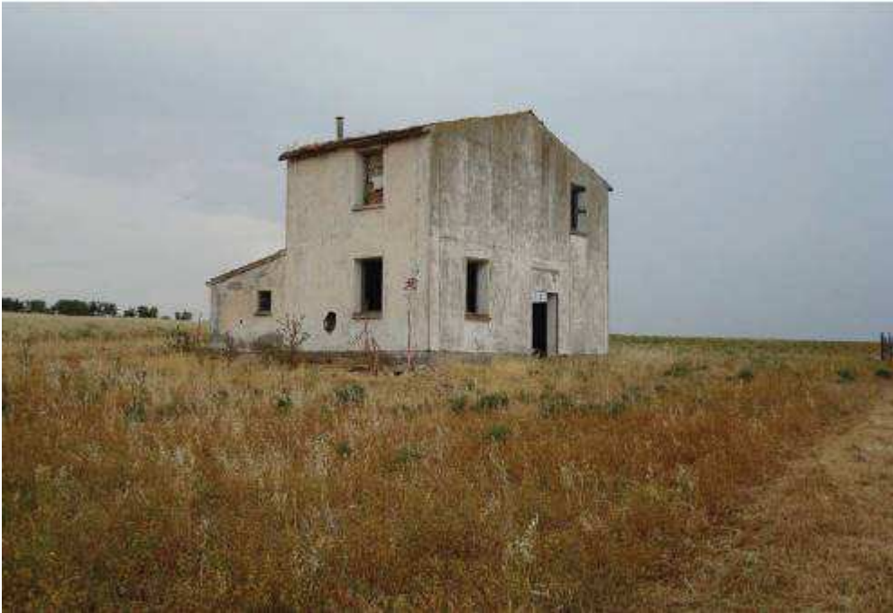
Fig. 2.25 - Tipica abitazione rurale del periodo della riforma fondiaria, anche esso in stato di abbandono.
