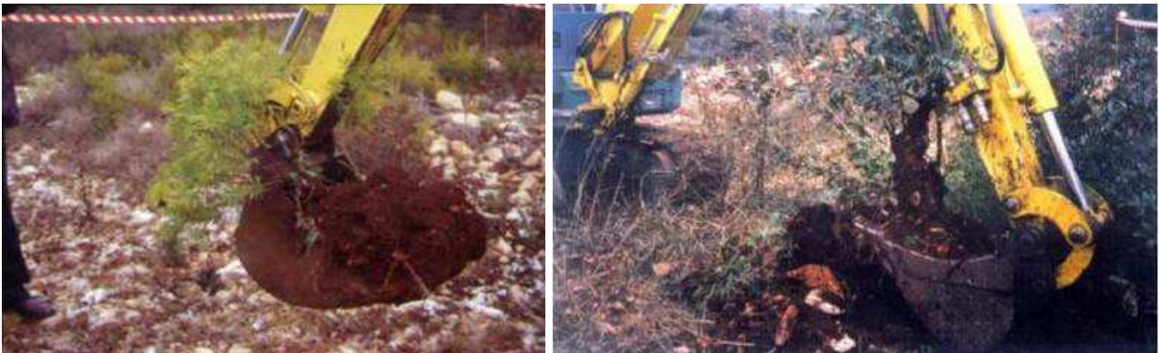
Fig. 5.14 - Trapianto di arbusti sul Metanodotto Bernalda – Brindisi, Loc. Massafra. Fonte: “Interventi di mitigazione a verde con tecniche di ingegneria naturalistica nel settore delle condotte interrato”, ISPRA 2015).
