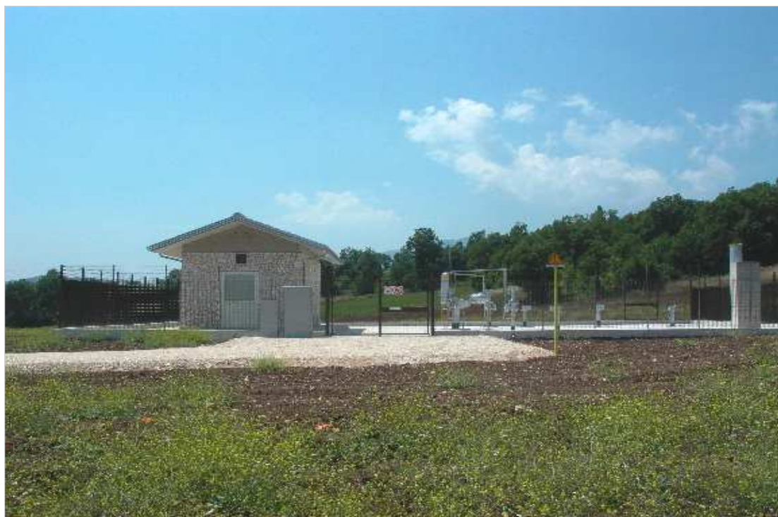
Fig. 9.2 - Punto di Intercettazione di linea (PIL).
