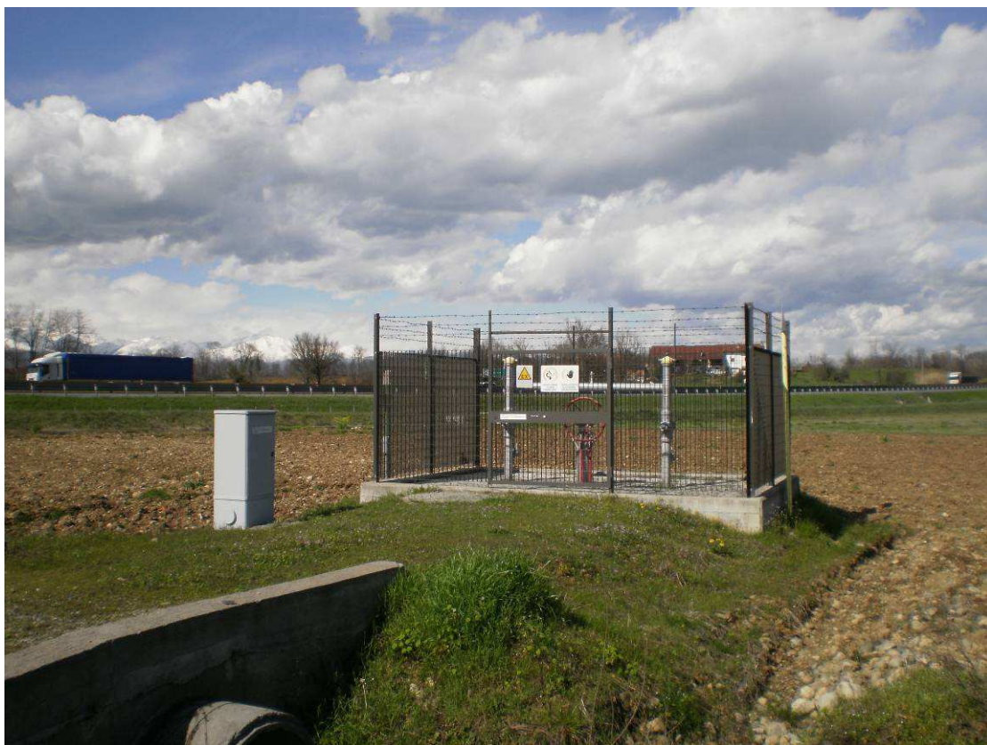
Fig. 5.18- Esempio di impianto di intercettazione di linea PIL.
