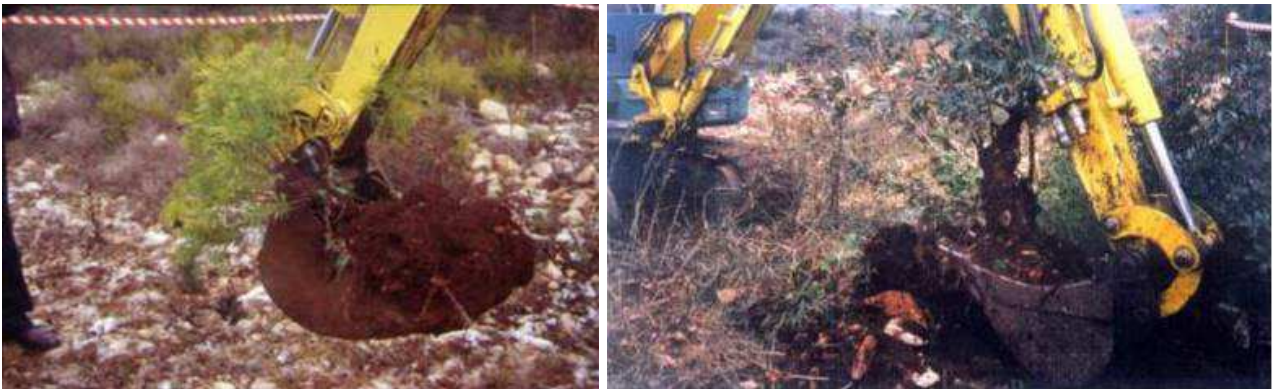
Fig. 8.14 – Trapianto di arbusti sul Metanodotto Bernalda – Brindisi, Loc. Massafra. Fonte: “Interventi di mitigazione a verde con tecniche di ingegneria naturalistica nel settore delle condotte interrate”, ISPRA 2015).
