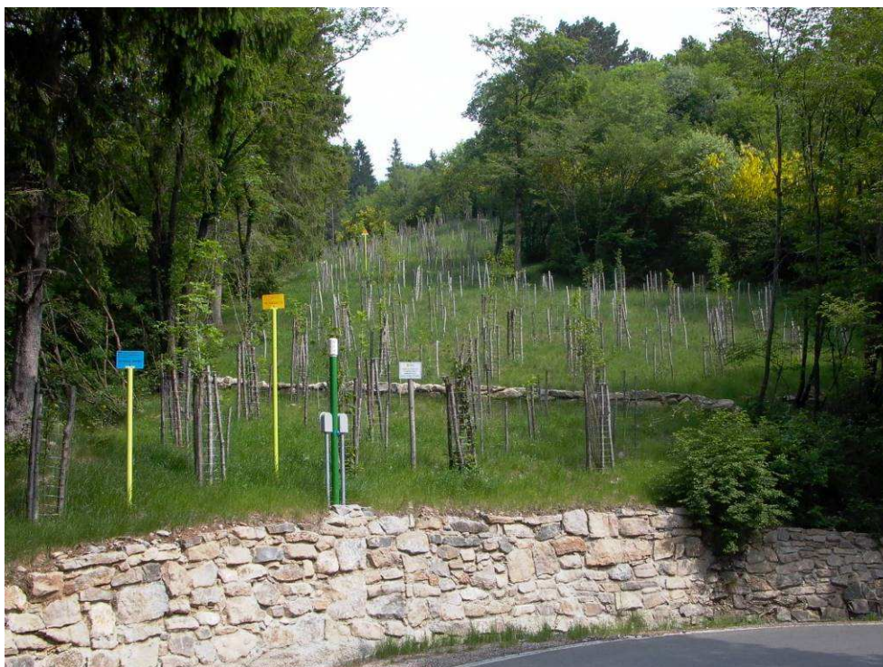
Fig. 9.5 - Ripristino vegetazionale con piantagione diffusa e protezioni individuali. Tubi di sfiato posto in corrispondenza di attraversamento eseguito con tubo di protezione.
