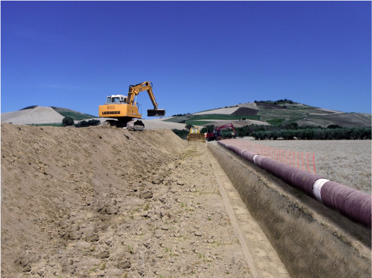
Fig. 3.3 – - Interferenza con agricole classificate come “Aree MN, Aree fluviali e di foce con particolare configurazione di carattere naturalistico e percettivo”(PTPAAV_1), nel comune di Montenero di Bisaccia, km 5+500 circa. Apertura dell’area di passaggio.
