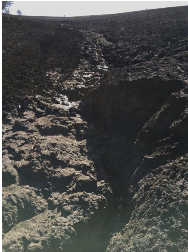
Figura 7.1-11 - Erosione concentrata delle argille di Montesecco (COS) nei pressi di Ururi - vicino progressiva km 42+050.
