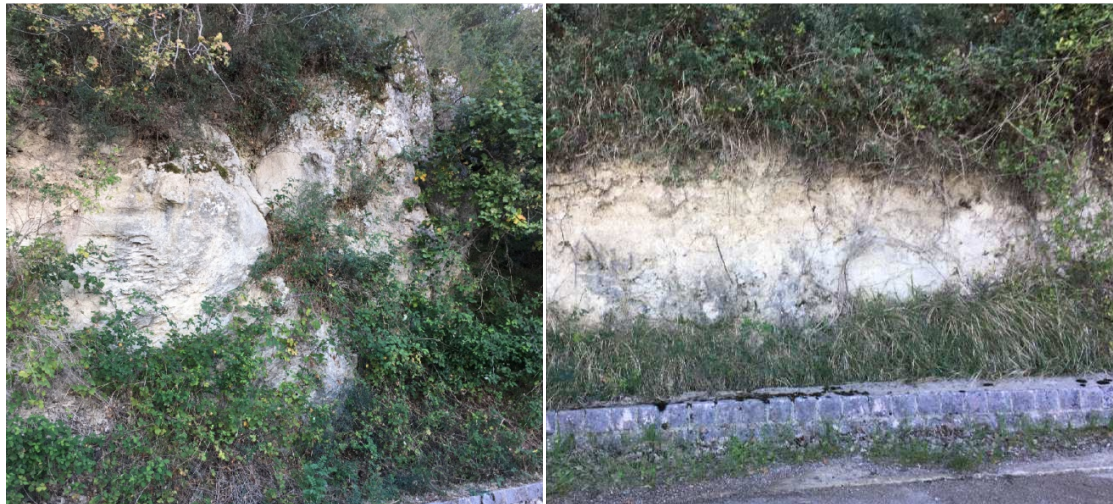
Figura 7.1-1 - Particolari di calcari marnosi (foto sx) e argille e argille marnose (foto dx), entrambi riferibili alla Formazione Faeto affioranti nei pressi del T. Pisciarriello, Montenero e Palata - vicino progressiva km 16+500.
