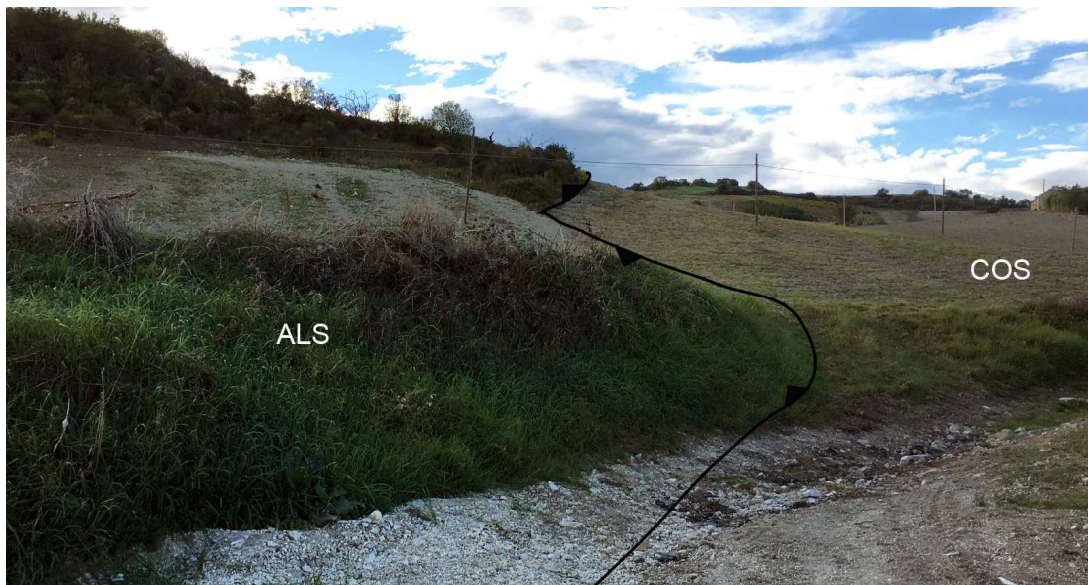
Figura 7.1-8 - Particolare del contatto tettonico tra il membro argilloso della formazione Faeto (ALS) e argille varicolori (COS) - vicino progressiva km 4+500.
