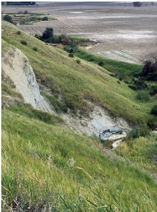
Figura 7.1-12 - Scalzamento al piede del versante costituito dalle argille di Montesecco (COS), ad opera del T. Tona - vicino progressiva km 52+800.
