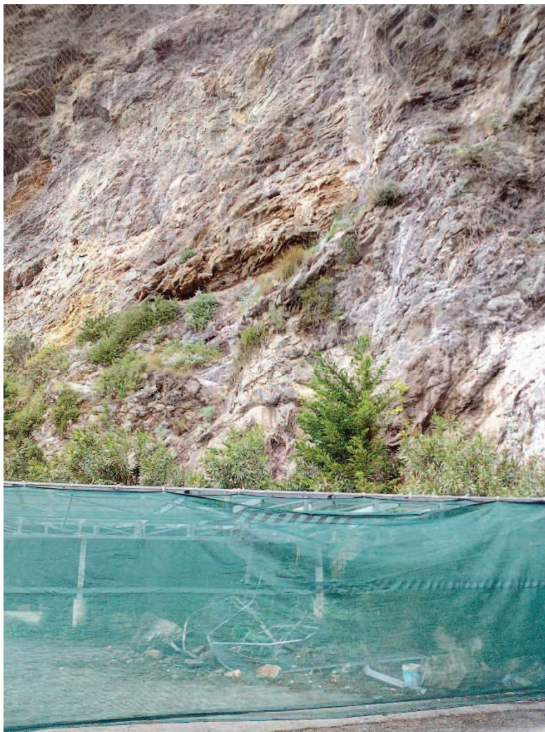
Fig. 5.4 – Massi caduti in corrispondenza del parcheggio del convento di San Francesco, immediatamente a destra (lato monte) dell'imbocco della galleria naturale dell'Alternativa 1.
