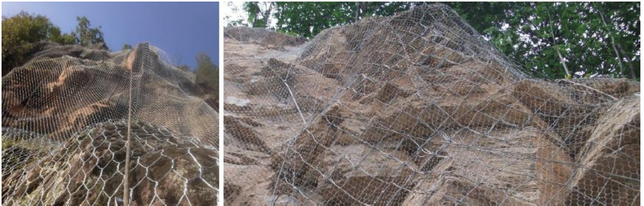
Figura 9-1 Sistemi di rafforzamento e stabilizzazione corticale: pannelli in fune e rete metallica a doppia torsione sulle pareti in prossimità degli imbocchi
