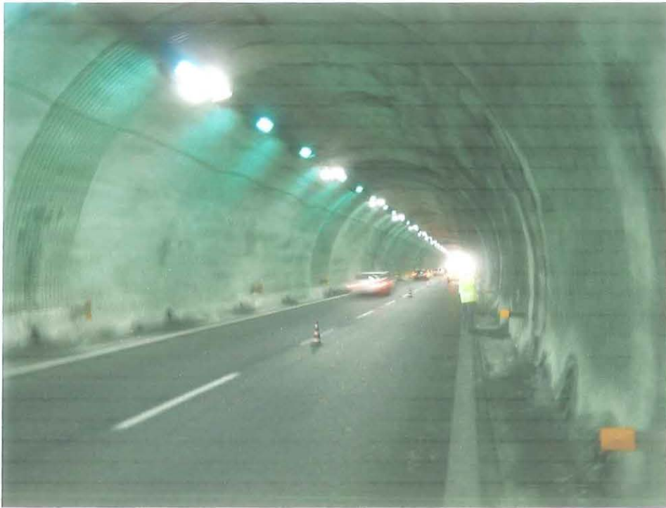
Fig. 4.25 – Stato della galleria in carreggiata Nord a giugno 2013
