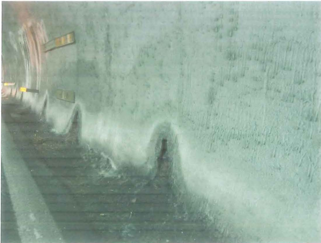
Fig. 4.27 – Galleria Nord, percolazioni dai barbacani, lato corsia di marcia
