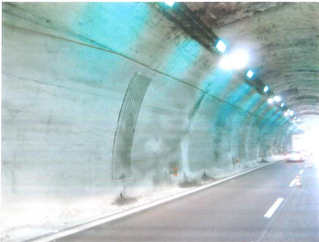
Fig. 4.38 – Campionamento 20 giugno 2013. Parete lato corsia di sorpasso
