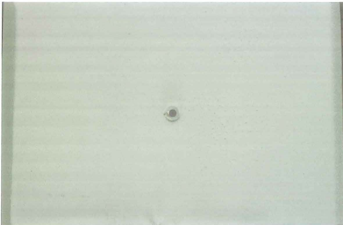
Fig. 3.5 - Tunnel Nord, pannello alto, 55 giorni di esposizione, supporto PVC, pitturato in situ
