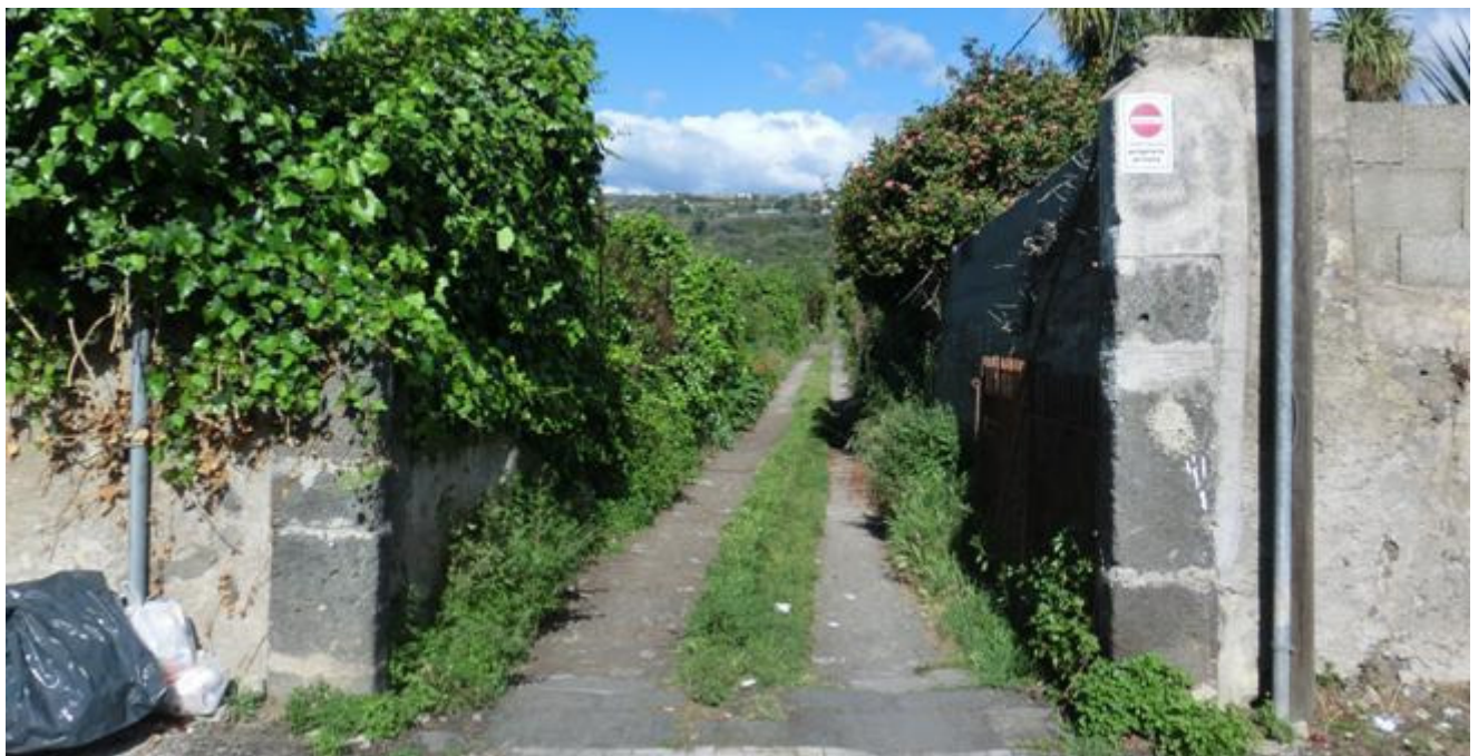
Accesso e strada da adeguare al transito dei mezzi (prevedere allargamento e rifacimento sede stradale)
