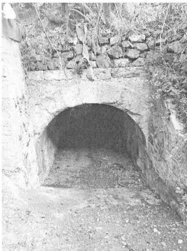
Denominazione Bene Tombino ad arco Km 319+507 Comune MESSINA Didascalia Vista da Nord/Ovest
