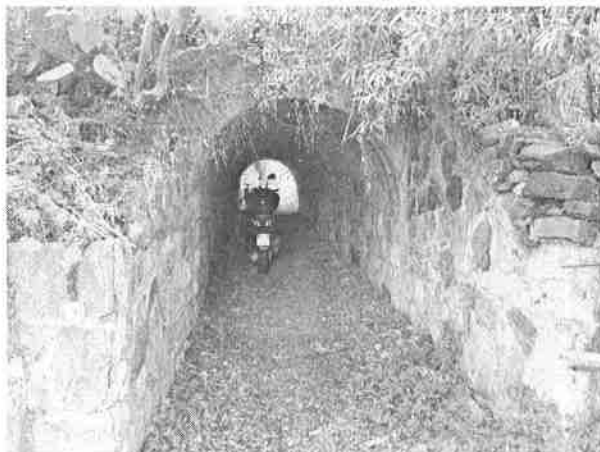
Denominazione Bene Tombino ad arco Km 319+507 Comune MESSINA Didascalia Vista da Sud/Est
